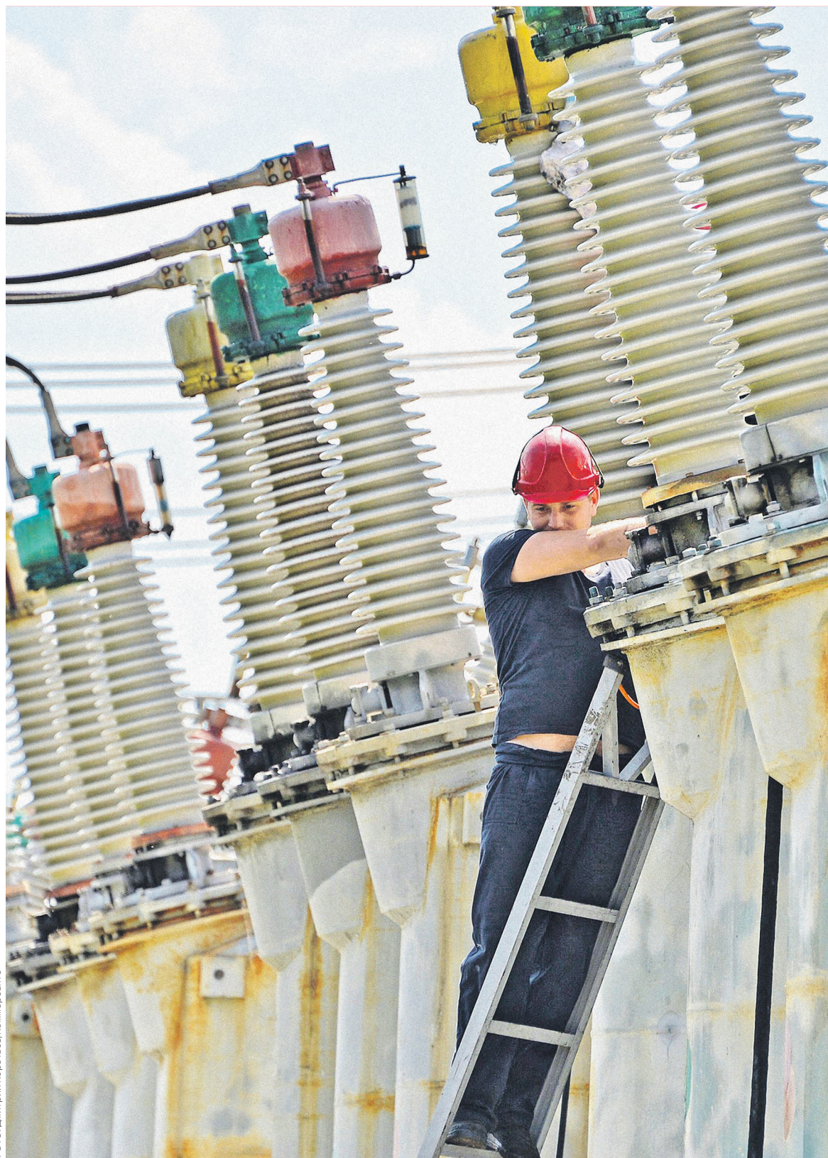
Правительство в 2012 году выделило «РусГидро» 50 млрд руб. на строительство четырех электростанций, но их стоимость за это время выросла с 89 млрд до 117,4 млрд руб. Благовещенская ТЭЦ (на фото) введена в эксплуатацию в 2016 году
