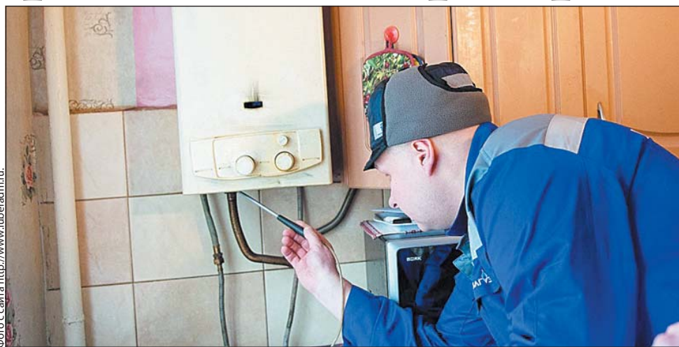
Шахтинцы жалуются на отсутствие технического обслуживания газового оборудования..
