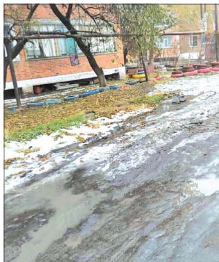
Порыв канализации на улице Станиславского.
