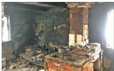
Предположительно, пожар произошёл из-за возгорания сажи в дымоходе печи.
