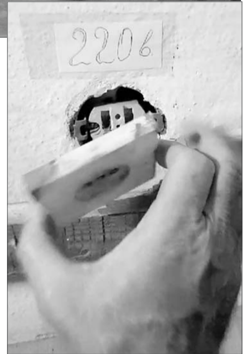
Лицевая панель розетки в зале была не закреплена.
