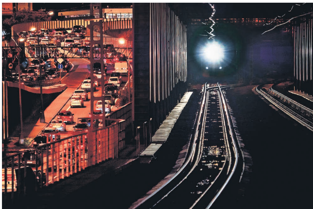
Строительство высокоскоростной пассажирской магистрали Москва—Петербург кажется ОАО РЖД светом в конце тоннеля для грузопотоков в порты северо-запада фото ГЕОРГИЯ РОЗОВА
