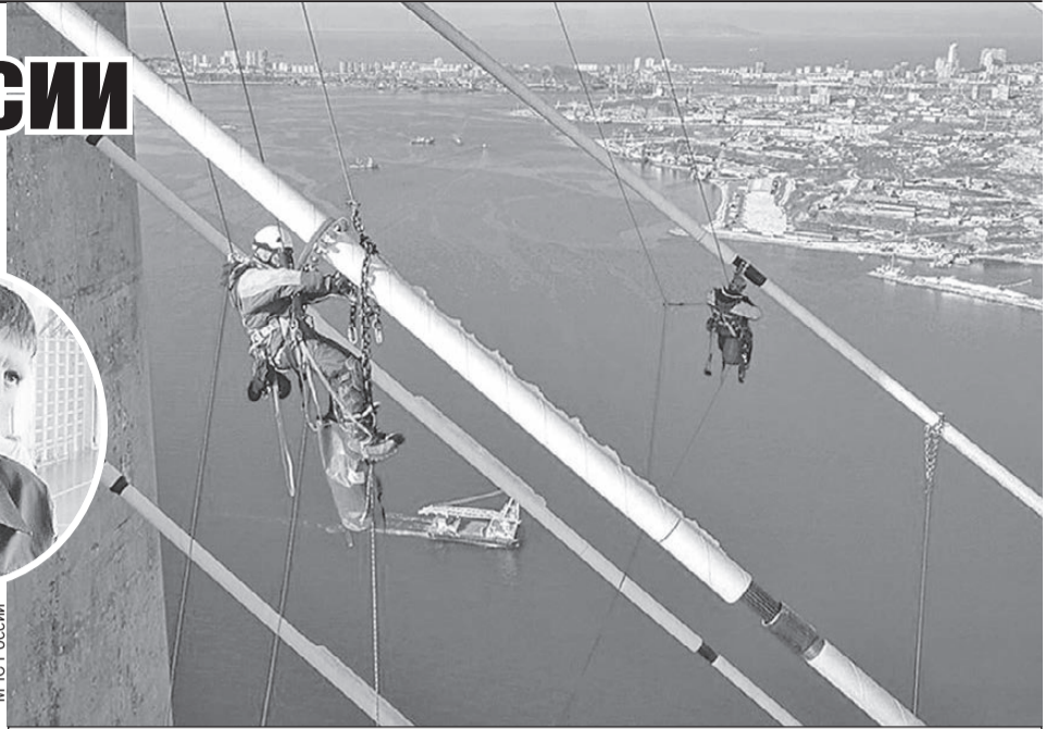
Иван Алехин забрался на мост на остров Русский и спасал его от обледенения.
