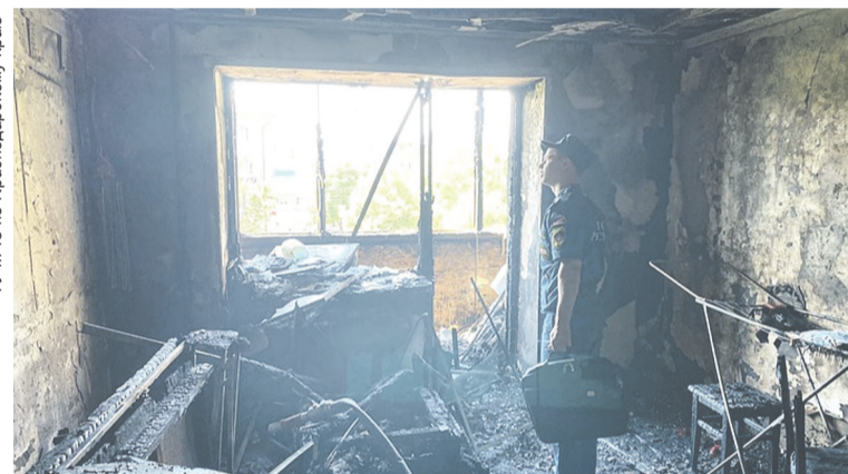
Квартира, в которой и случился пожар, сгорела дотла.
