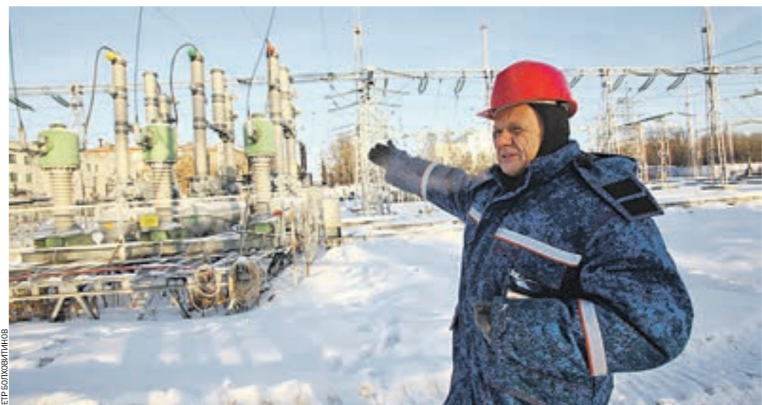
Вчера 11.00 Дежурный Михаил Полионов знакомит «Вечерку» с работой подстанции «Южная»
