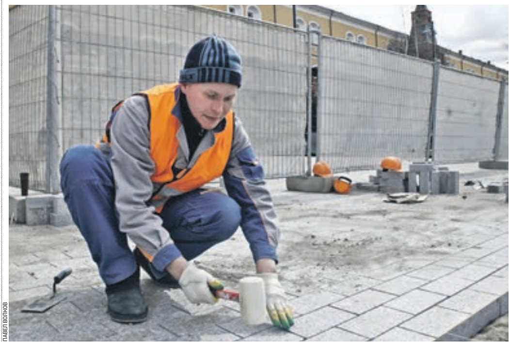
Вчера 11:20 Рабочие заканчивают укладку гранитной плитки на территории Александровского сада. К началу мая все садовые растения наконец-то смогут «вдохнуть» свободно
