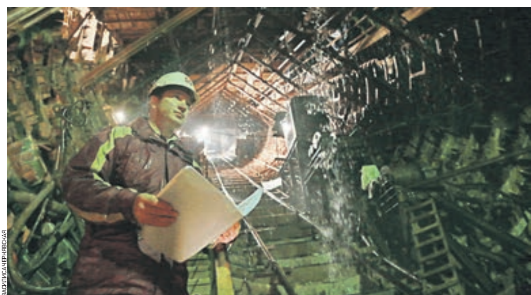
16 мая 2015 года 12:47 Заместитель гендиректора Мосметростроя Олег Мельников осматривает станцию «Окружная». Еще в прошлом году строители справились с подполнением. Теперь тут сухо
