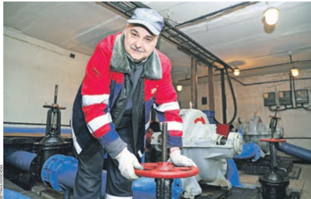
Вчера 14:21 Оператор фонтана в «Сокольниках» Герман Ермачков проверяет оборудование
