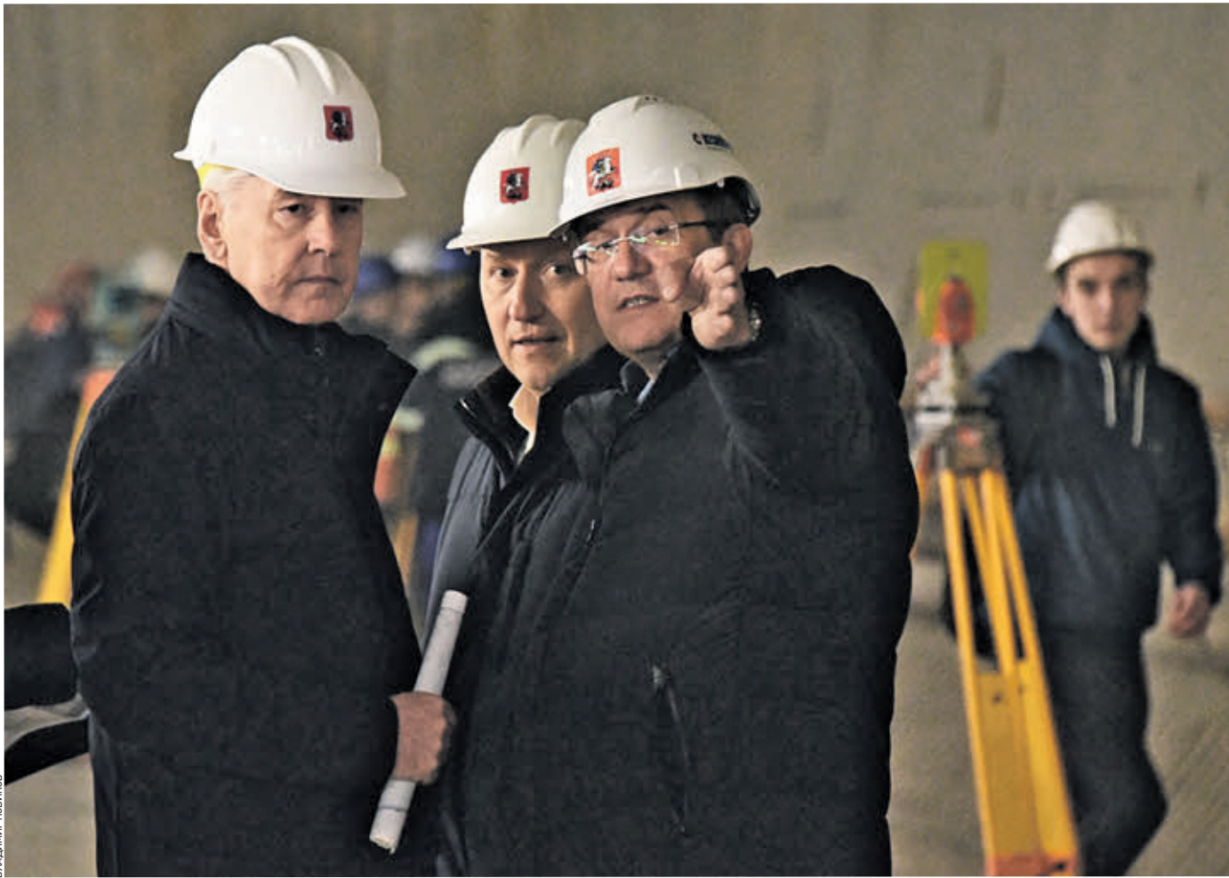
Вчера 14:02 Слева направо: мэр Москвы Сергей Собянин, глава столичного Департамента строительства Андрей Бочарев и генеральный директор АО «Мосинжпроект» Марс Газизуллин осматривают ход возведения станции метро «Юго-Восточная»
