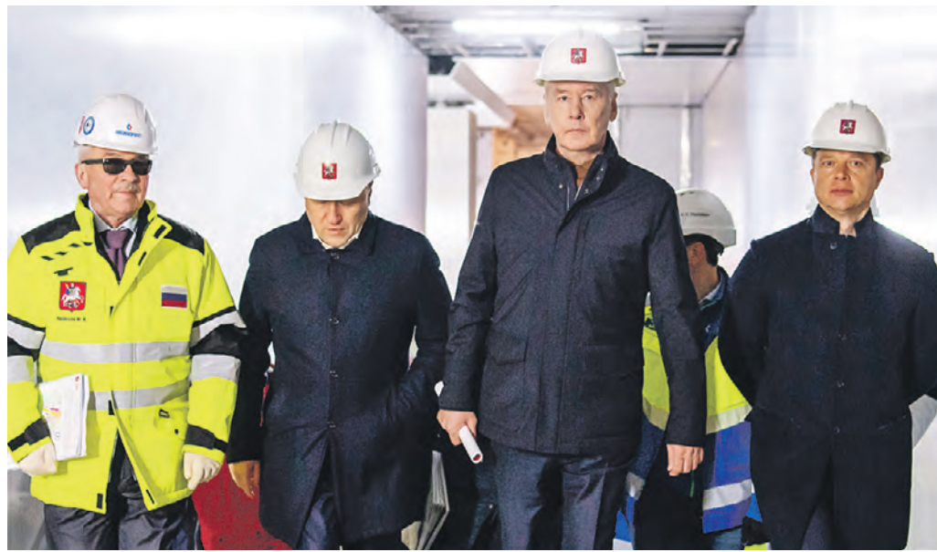
Вчера 13:15 Слева направо: гендиректор компании-генподрядчика Юрий Кравцов, заммэра Андрей Бочкарев, мэр Москвы Сергей Собянин и заммэра Максим Лисутов осматривают ход работ на станции «Печатники» Большого кольца метро
