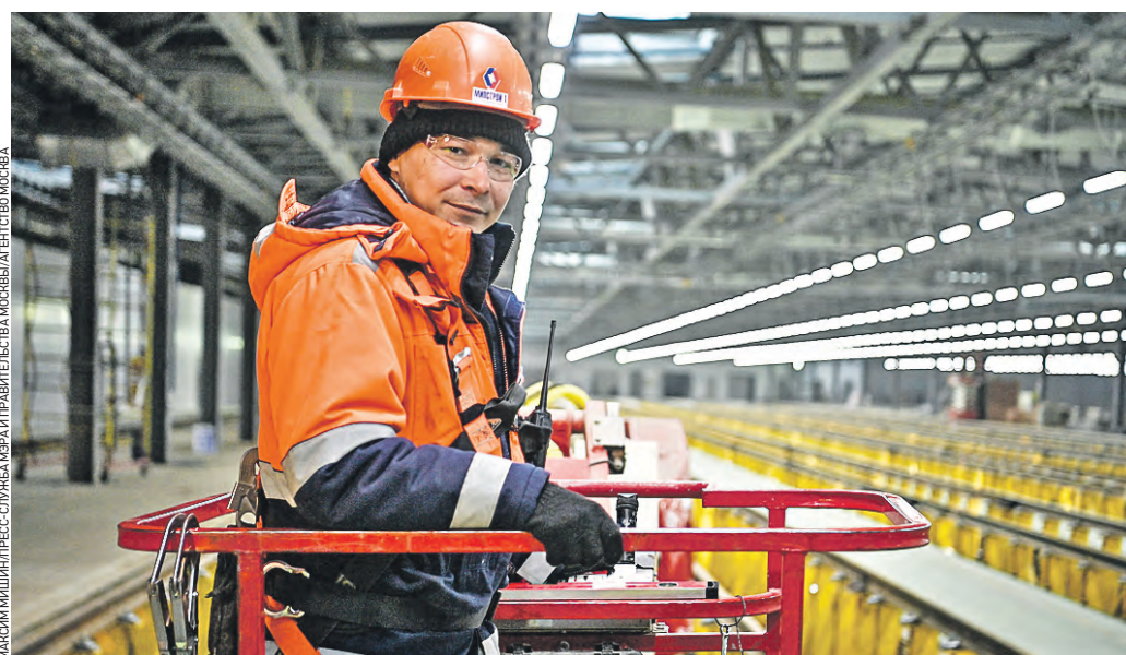
24 января. Рабочий Рустам Ильхамов проверяет работу осветительных приборов в строящемся электродепо «Южное» Замоскворецкой линии метро
