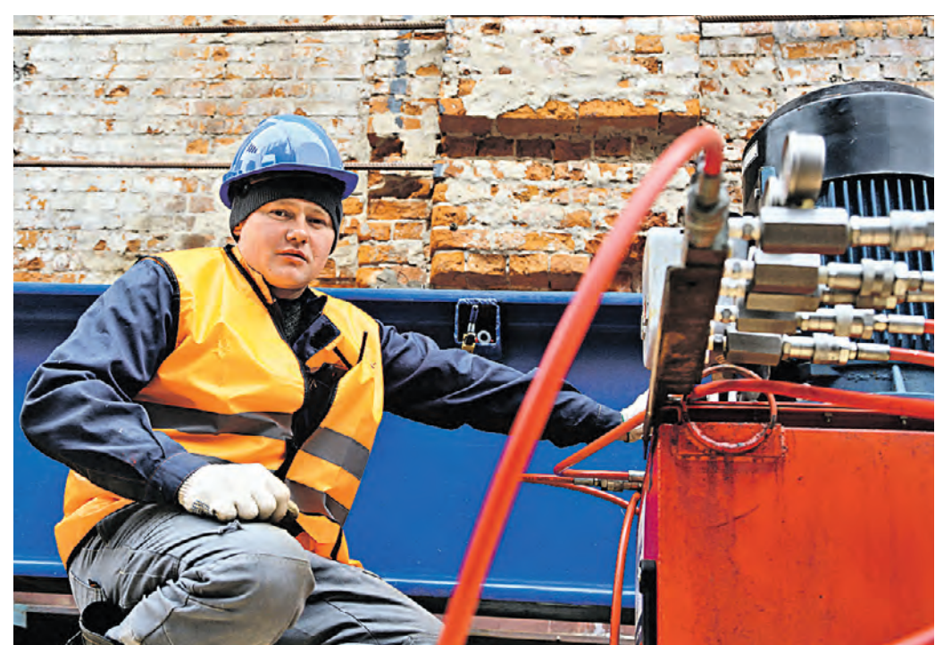
29 марта. Гидравлик Николай Есин следит за работой гидроцилиндров. Они толкают водонапорную башню, которая на катках едет по рельсам. Фото: Наталья Шатохина
